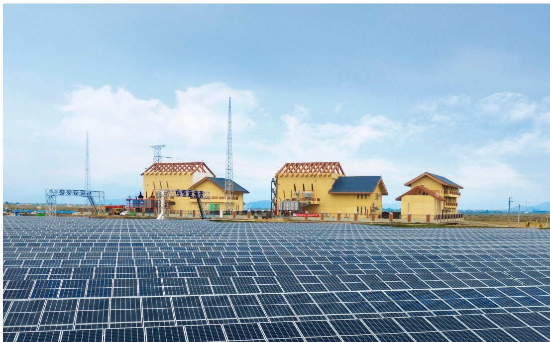
图 1-10 广东台山海宴镇 500 兆瓦渔业光伏发电项目 (广东江门恒光新能源有限公司供图)
